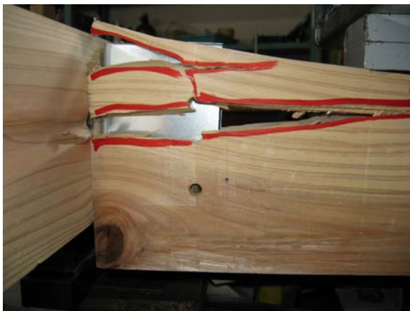
写真9 梁小口の割裂②
