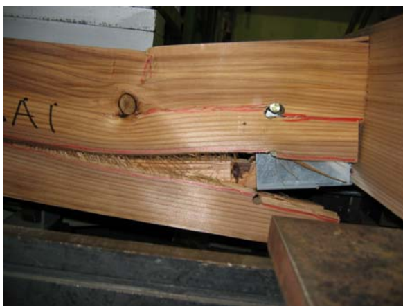
写真7 梁小口の割裂②
