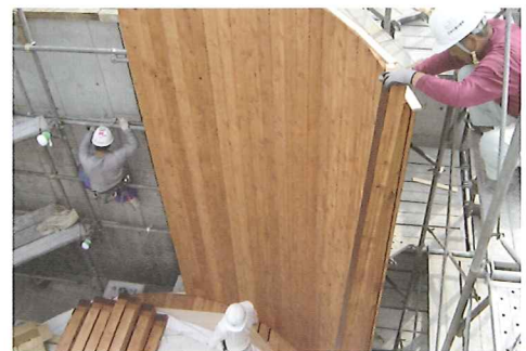
職人の丁寧な仕事により加工された部材を現場で組立
