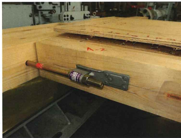
写真 1.14 A-2 試験終了後 釘の抜け、釘の破断、パンチングアウト
