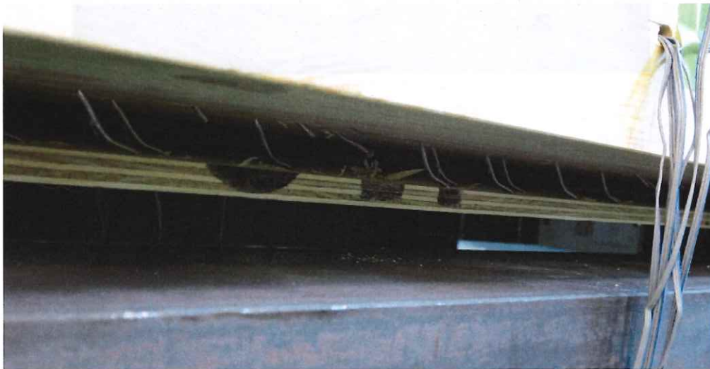
写真 1.43 B-3 試験終了後 釘の抜け、釘の破断、パンチングアウト
