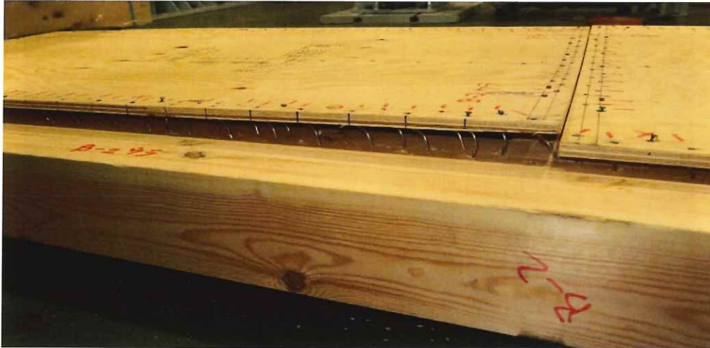
写真 1.35 B-2 試験終了後 面材の浮き
