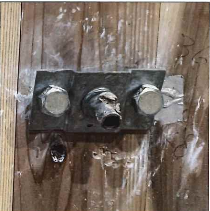
写真 2-75 仕様 36 の解体時 (CLT 表面) (直貼 コーチボルト M16+足改良-1+外壁 2)
