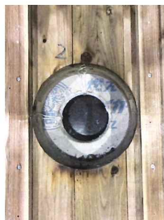
写真 1-12 仕様 2 の解体時（CLT 躯体） （かぶせタイプ 鋼管 100,GB-F(V)21mm 厚×2 枚+RW）
