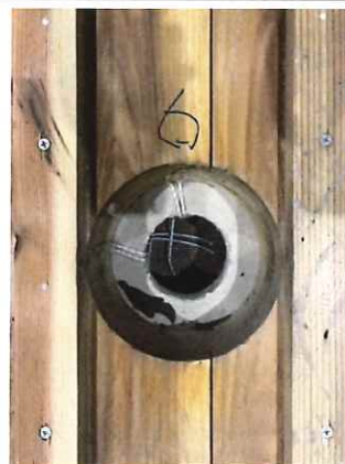
写真 1-18 貫通部・仕様 6 の解体時 (かぶせタイプ 鋼管 50GB-F(V)21mm 厚×2 枚+RW)
