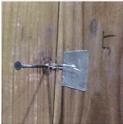
写真 1-21 仕様 1 の解体時（CLT 表面） （単独 N65 くぎ）
