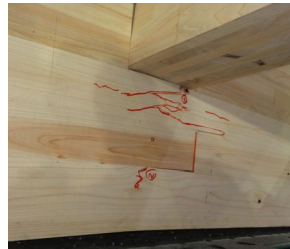
No1下側CLTの曲げ破壊
