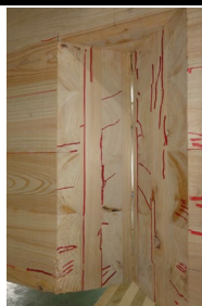
上側CLT接合部の割れ
