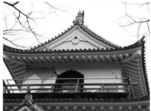
写真4-16 白石城 漆喰のはく離
