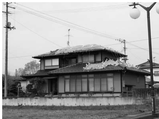
写真4-5 瓦の落下被害(川崎町)
