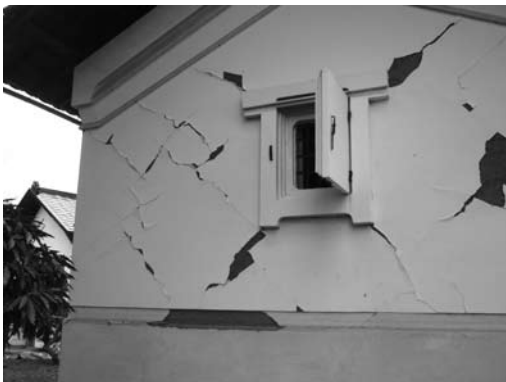
写真4-11 壁のせん断割れ
