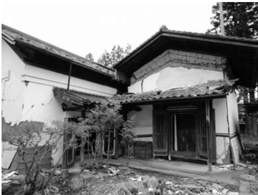
写真4-10 旧有壁本陣 土蔵の崩壊
