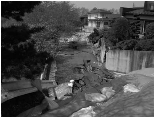
写真4-27 地盤の変状(秋田県立大学板垣准教授撮影)
