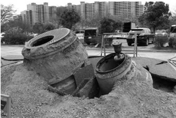
写真5-3 災害用 飲料水兼用型耐震性貯水槽のマンホール
