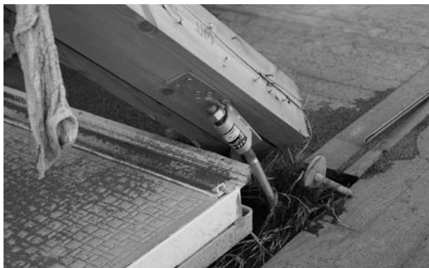
写真2-11 曲がったアンカーボルト(野蒜)
