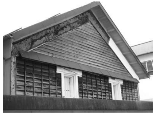
写真4-15 白石市の土蔵被害
