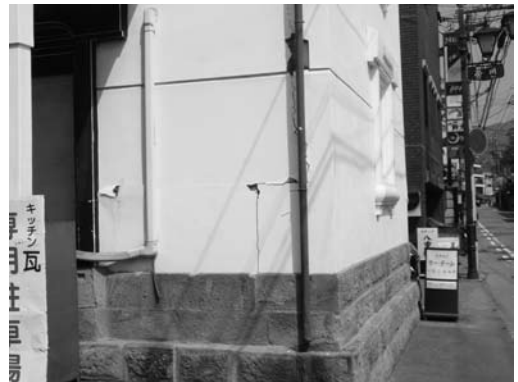
写真4-14 会津若松市の土蔵被害
