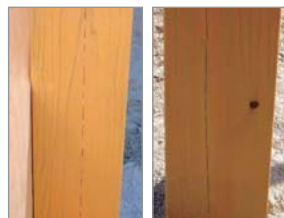
写真6 干割れが発生した柱 (山側の空中デッキ柱)
