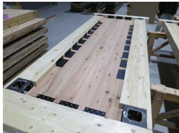
図 2 5 柱・梁が取り付けられたプレハブ化された CLT 耐力壁
